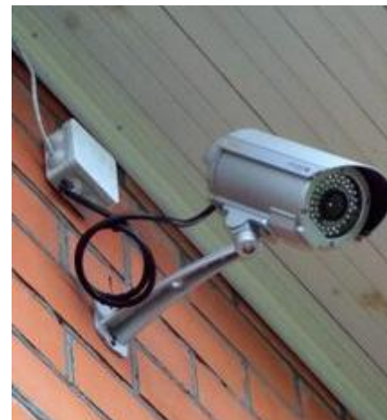
Отсутствие защиты (открытая проводка)
